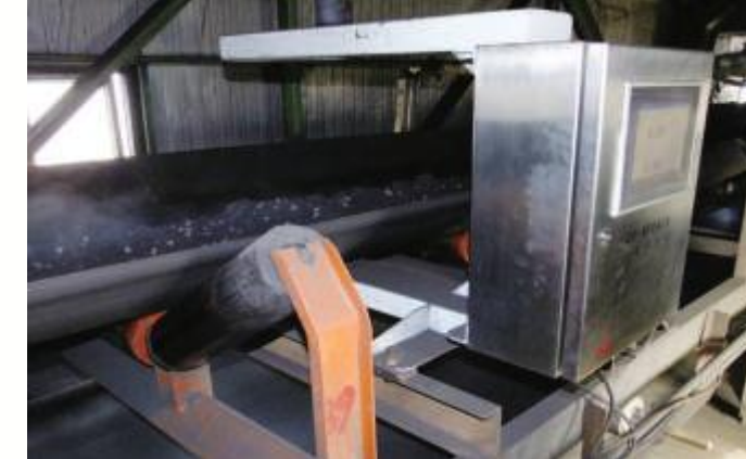
Микроволновой влагомер DF-MMA I, применяемый для дозирочной технологии на Коксохимическом заводе при Бэньсиской металлургической корпорации
